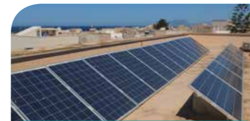
Système solaire photovoltaïque installé sur le toit de la casa comunale (mairie) de Favignana, Italie
